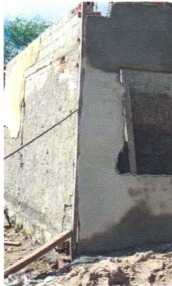
FOTO 05 – COMPOSIÇÃO REPRESENTATIVA) EXECUÇÃO DE ESTRUTURAS DE CONCRETO ARMADO, PARA EDIFICAÇÃO HABITACIONAL UNIFAMILIAR TÉRREA (CASA EM EMPREENDIMENTOS) FCK=25MPÁ. AF_01_01/2017
