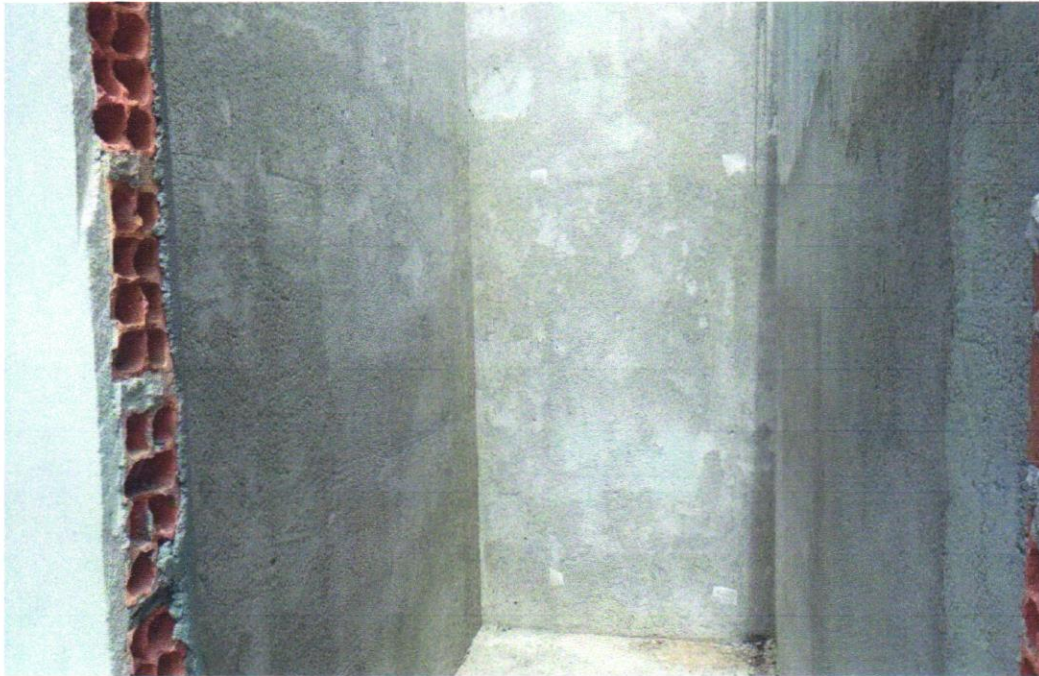
FOTO 13 - MASSA ÚNICA, PARA RECEBIMENTO DE PINTURA OU CERÂMICA, ARGAMASSA INDUSTRIALIZADA, PREPARO MECÂNICO, APLICADO COM EQUIPAMENTO DE MISTURA E PROJEÇÃO DE 1,5 M3/H EM FACES INTERNAS DE PAREDES, ESPESSURA DE 5MM, SEM EXECUÇÃO DE TALISCAS. AF_06/2014
