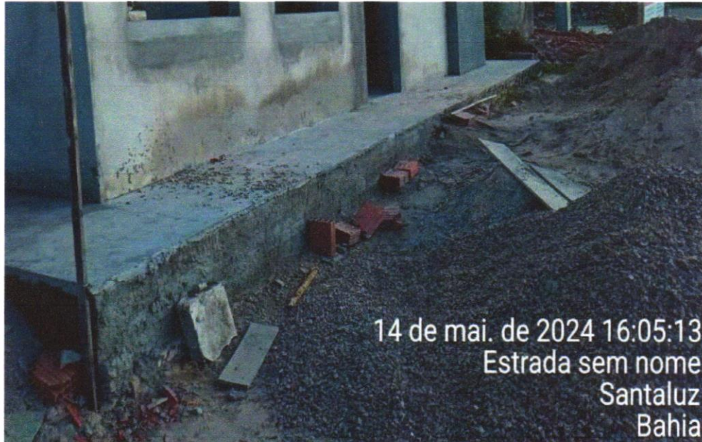
FOTO 15 - EXECUÇÃO DE PASSEIO (CALÇADA) OU PISO DE CONCRETO COM CONCRETO MOLDADO IN LOCO, USINADO, ACABAMENTO CONVENCIONAL, NÃO ARMADO. AF_07/2016
